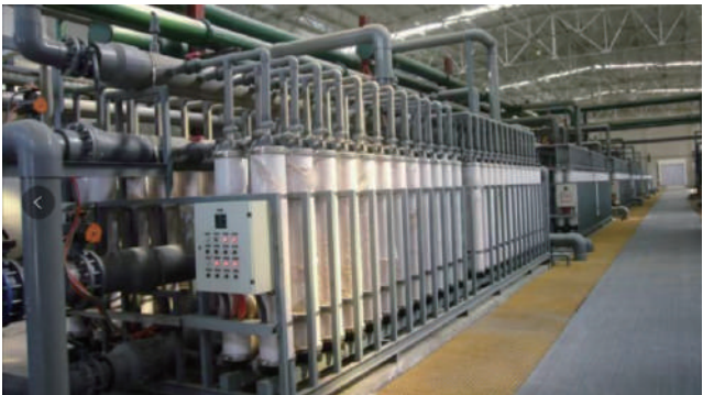
1000吨每小时超滤项目 1000 tons per hour UF system project
