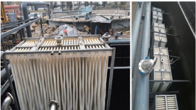
日处理10000吨污水项目 Daily treatment of 10,000 tons of sewage project
